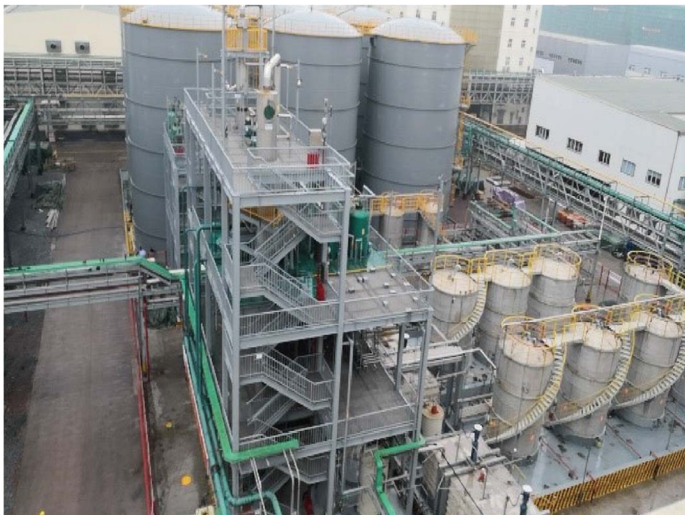
ORZ高效除油树脂及废水深度除油技术示范工程项目
